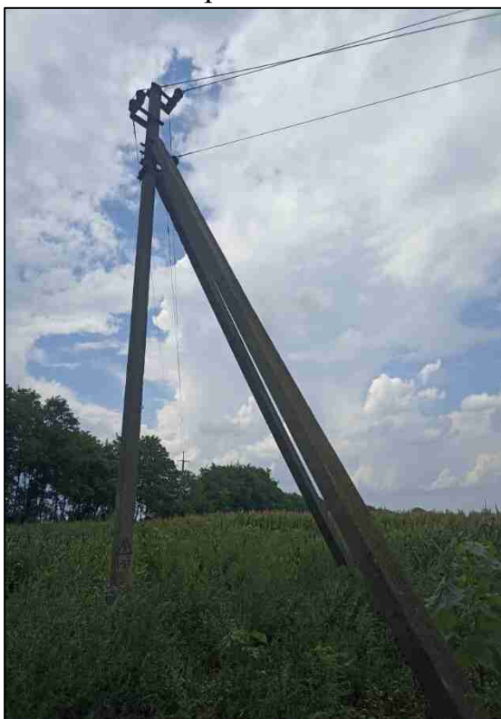
Опора № 1/57 ВЛ-10 кВ БП-3
